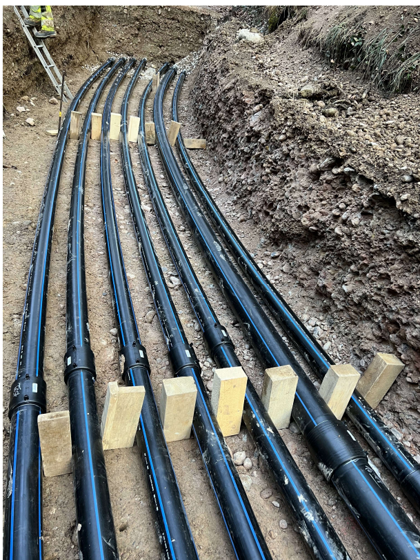
«Sammelleitungen der Quellfassungsanlagen Tobelmühle»
